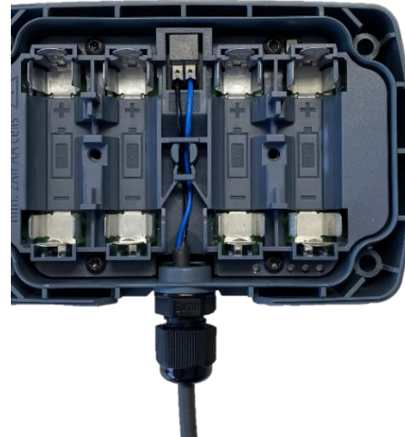
Alimentazione elettrica permanente a 24 V CC
